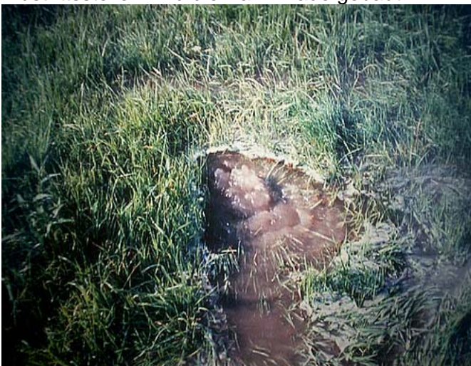
Foto 12: trüber Wasseraustritt, mit Sedimenten
