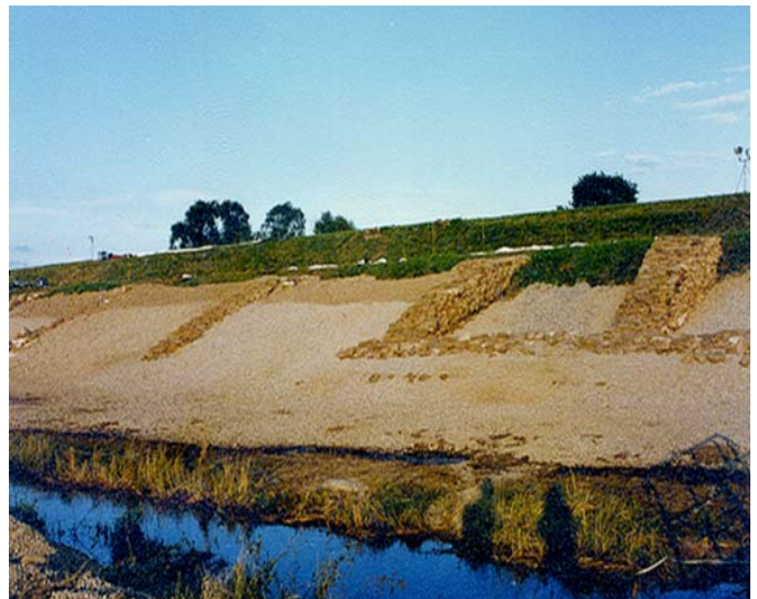
Foto 35: massive landseitige Sicherung
