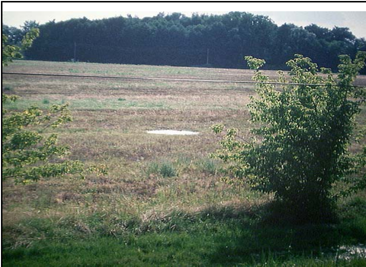
Foto: 36: Schadstelle im Deichhinterland, Blick von der Deichkrone
